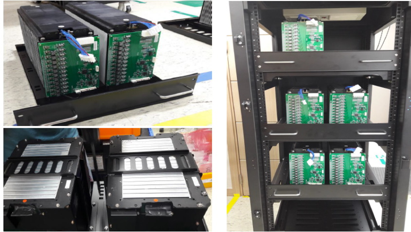
[그림 4] 제주한전에 설치, 공급된 전기차 배터리 이차사용 UPS
