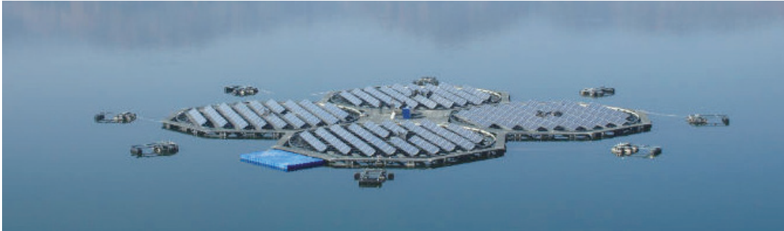
그림 7 합천댐 추적식 수상태양광
