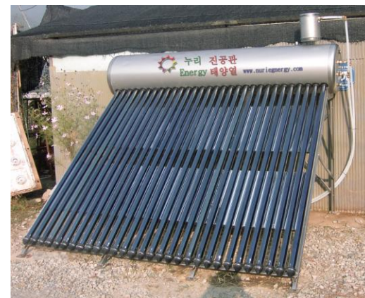
주차장에 설치된 태양열 시스템
