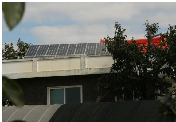
옥상에 설치된 태양광 시스템
